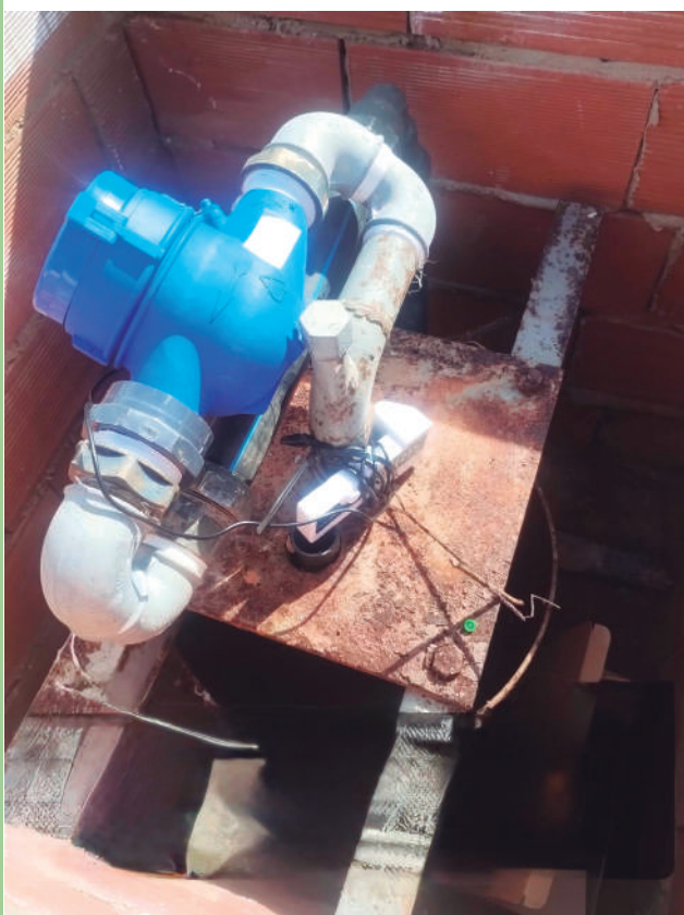
Instalación de contador digital de pozo
